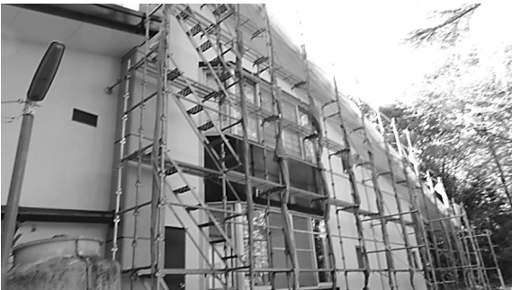
被害箇所調査中の研修棟
